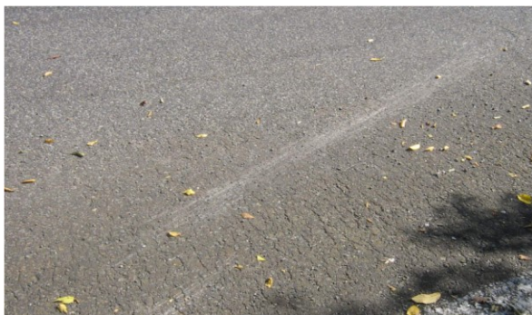
Asfalt je korodovaný a drolí se
