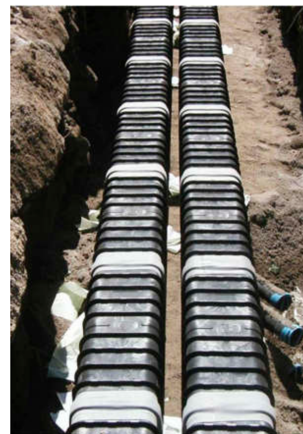
Kabelovody umožňují vedení kabelových sítí s minimálními požadavky na prostor.
